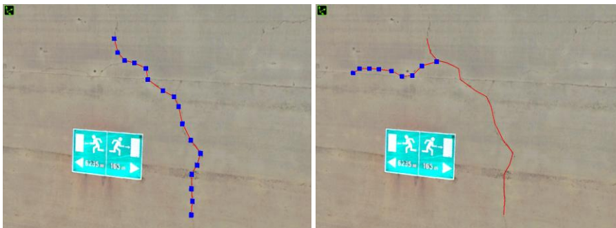
Abb. 2: Markierung von Rissen durch Picking mehrerer Positionen
